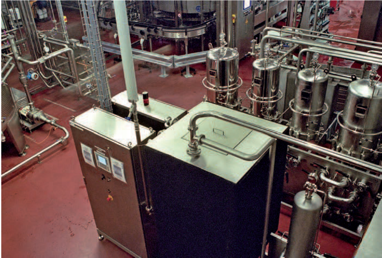
Abfüll-Filtrations-Anlage mit zwei Filterlinien und CIP-Behälter mit Spülwasserfilter; Leistung Abfüll-Filtration: 14000 l/h
